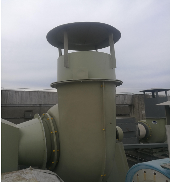
废气处理活性炭吸附装置及排气口
